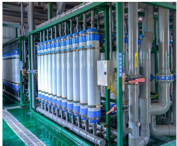
纯水系统氮封排水回用设备
