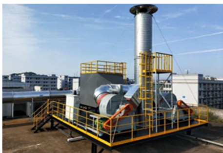
屋顶废气处理设施
